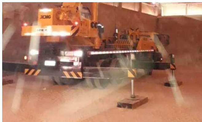
Patolamento do guindaste.
